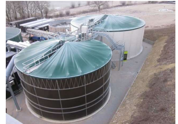
WWTP Simpelveld 12.600 PE á 150 TOD
