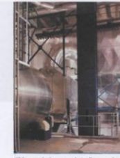
slibdroger Venlo: droogruimte, verbrandings- en afgasruimte
