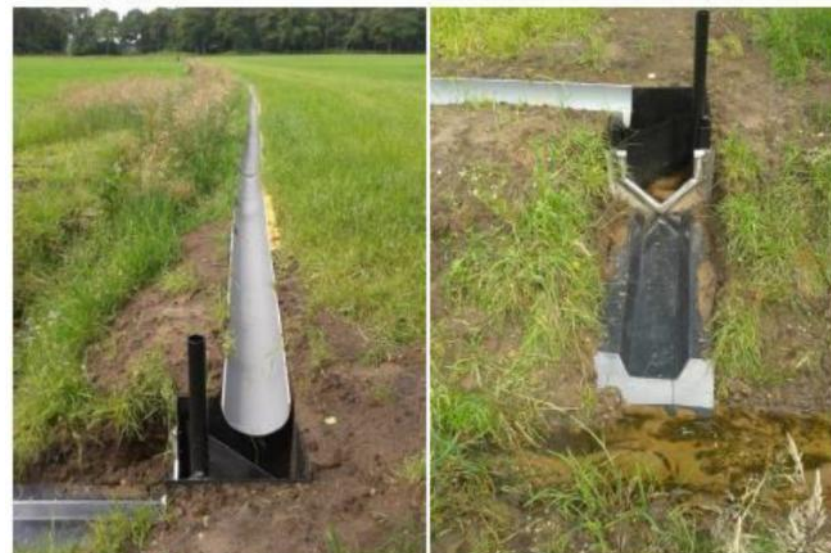
Figuur 3.1 Impressie van een opvanggoot met meetpunt voor het opvangen en meten van maai-veldafvoer
