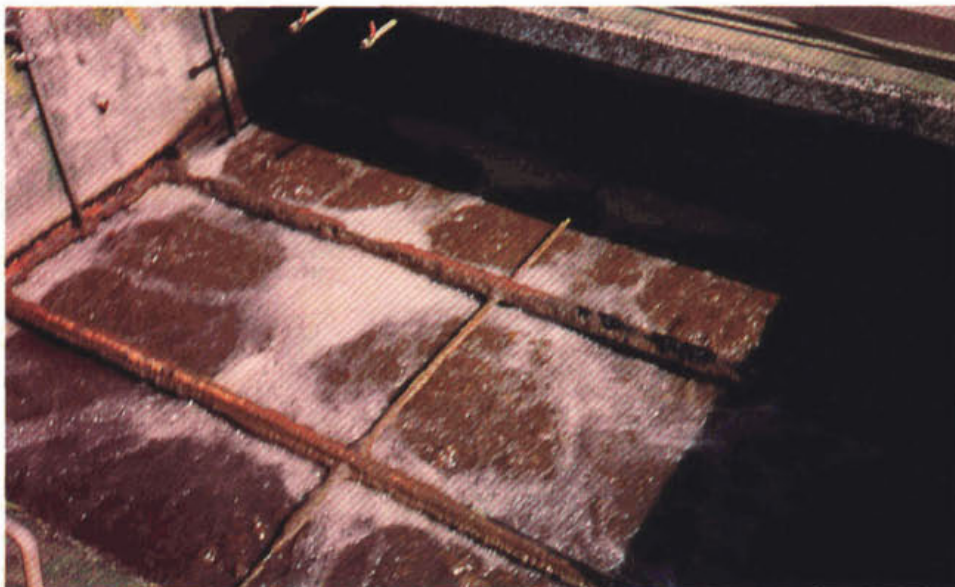
Figuur 24: De beluchte gecompartmenteerde selector van de RWZI Baarle-Nassau
