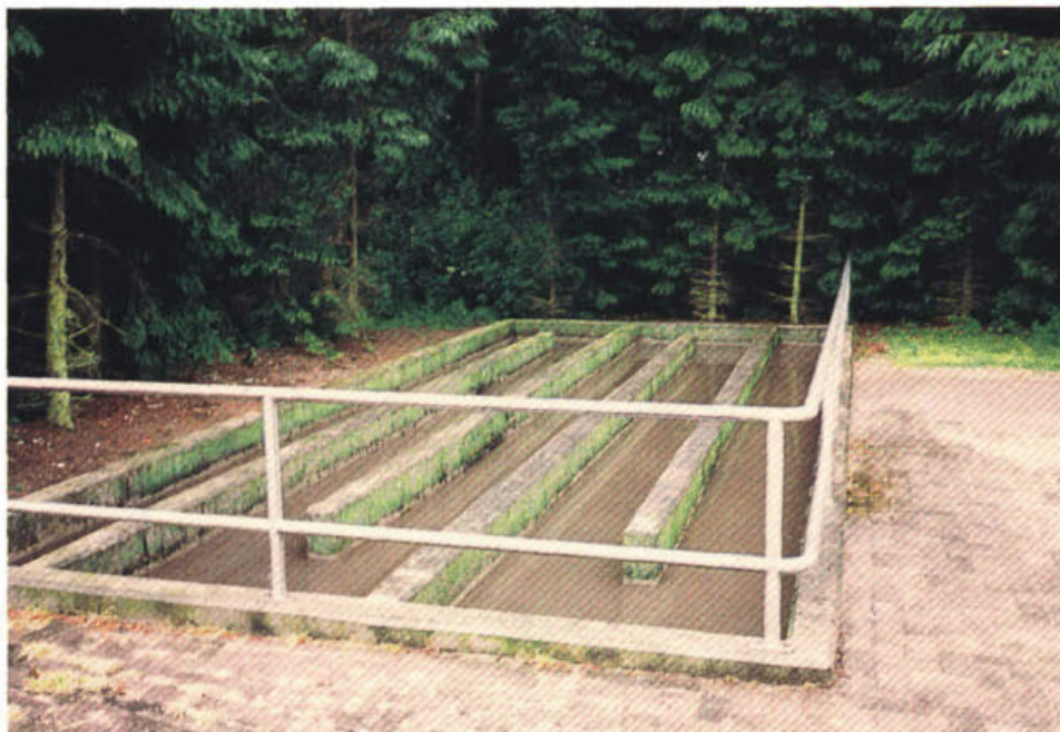
Figuur 25: De selector van de RWZI Gramsbergen heeft reeds een uitstekende propstroomkarakter
