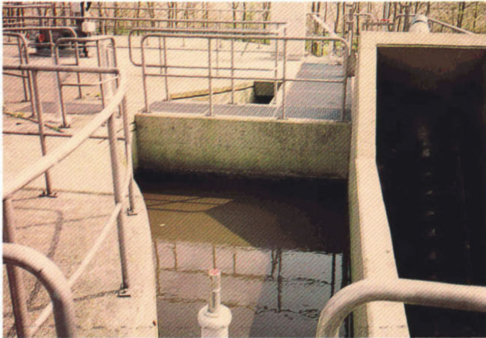
Figuur 23: De selector van de RWZI Oude Tonge; luchtinslag ten gevolge van de slibretourvizels
