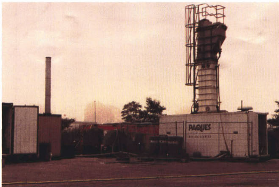
Figuur 5 Overzicht van de proefinstallatie met de airlift-reactor op de rwzi Utrecht
