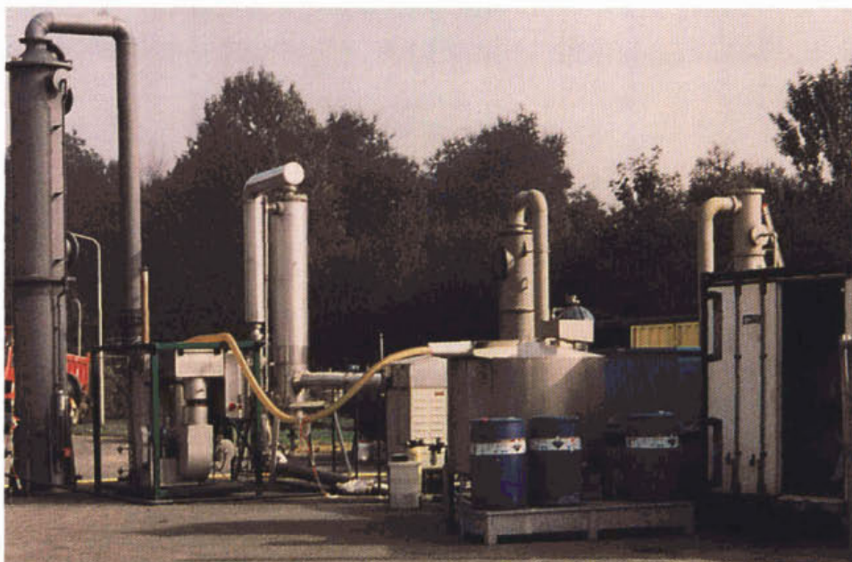
Figuur 10 Overzicht van de proefinstallatie voor het stoomstrippen op de rwzi Utrecht
