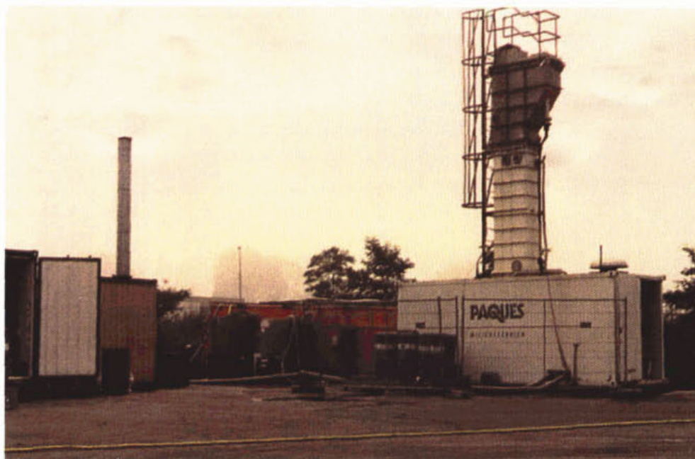
Figuur 3 Overzicht van de opstelling van de proefinstallatie op de rwzi Utrecht
