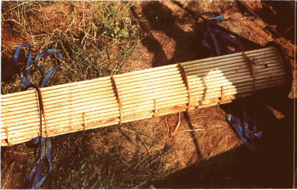
Figuur 6 Scaling in de warmtewisselaar
