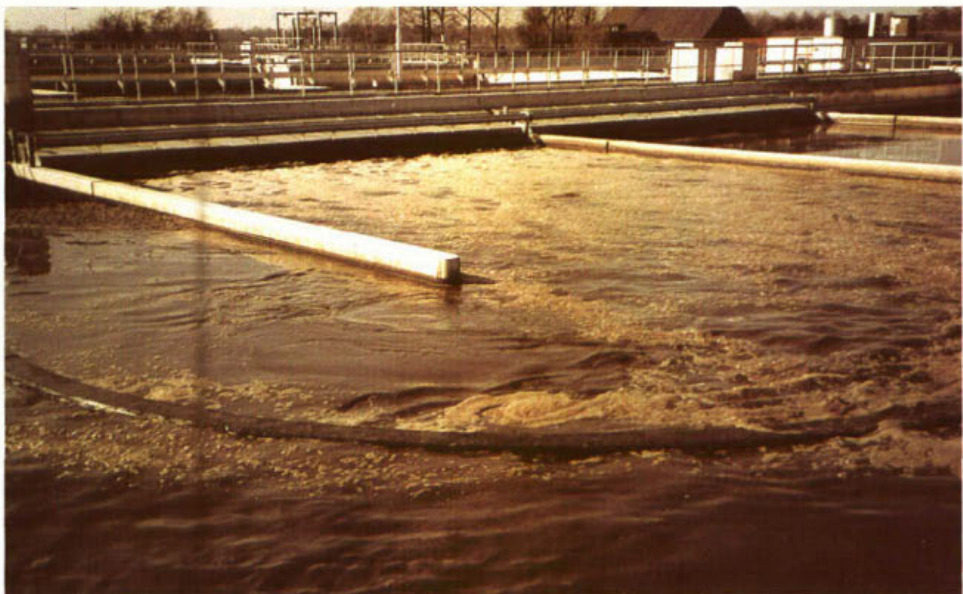
Het omloopsysteem van de rwzi Ede-Wageningen volgens het Bio-Denitro-proces. De rapporten R/90-06 en STOWA rapport 92-15 beschrijven de nutriëntverwijderingsprocessen.
