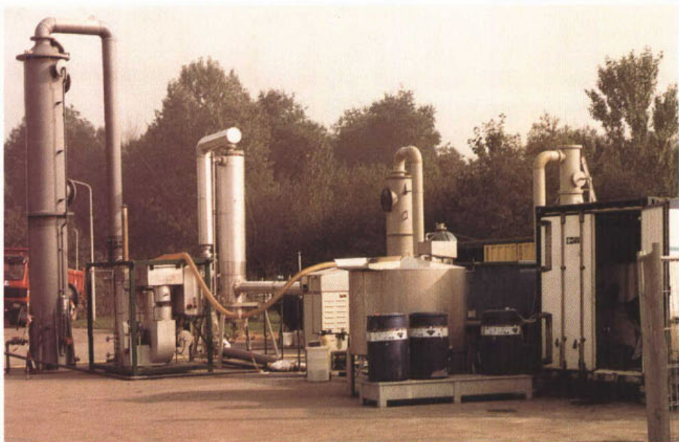
Proefinstallatie op de rwzi Houtrust. Gebruikt bij het onderzoek aan de nitrificatie en denitrificatie in compactsystemen, dat beschreven is in STOWA-rapport 93-13.
