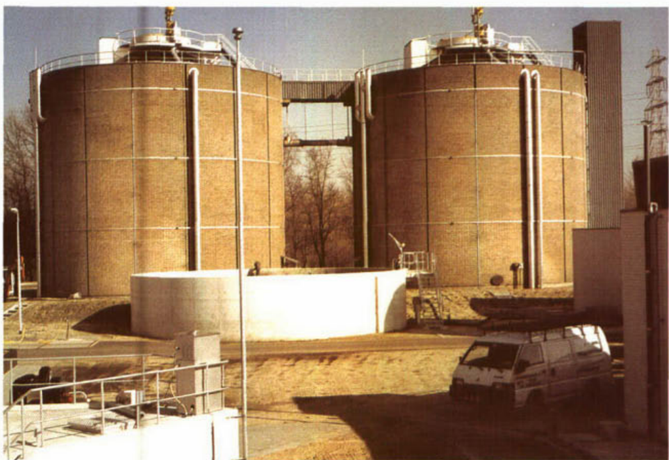
Gistingstanks op de rwzi Ede. Het belang van een goed functionerende gisting komt tot uiting in de STOWA-rapporten 83-07 en 85-02
