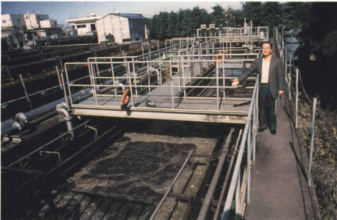
Figuur 1.4: Demonstratiereactor (volume 750 m 3 ) met in polyethyleenglycol geïmmobiliseerd nitrificerend slib bij de rioolwaterzuivering van Takimoshita. Persoon bij reactor is Dr. Emori, de projectleider van het PEGASUS project van Hitachi.
