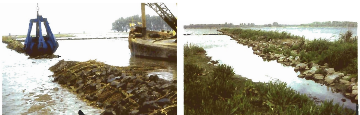
Abbeelding 2.7 Aanleg van een doorgroeiakrib langs de Nieuwe Merwede en twee jaar na aanleg. (Foto's J.L. Koolen)
