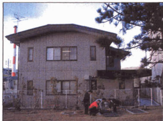
Figure 6 - Johkaso tank treatment in Japan (Kubota)
