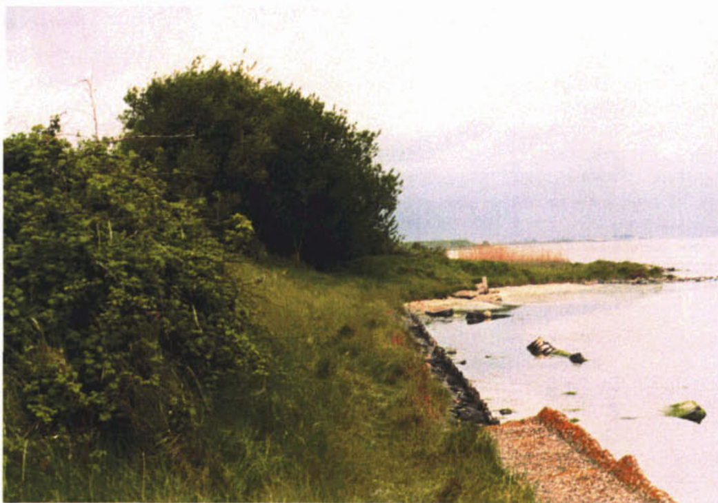
Figuur 5.5 Aanwezige struiken op het buitentalud
