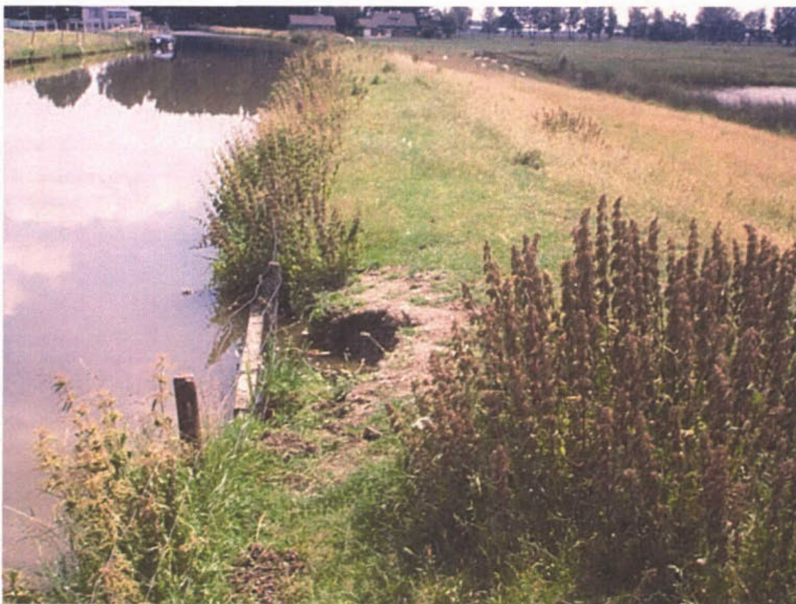
Foto 7: Een beschadigde oever langs de Groeneveldse Watering
