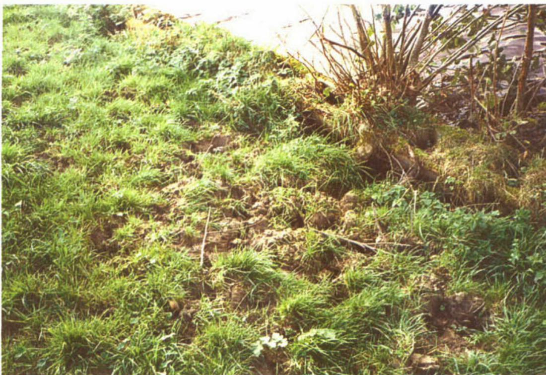
Foto 6: Beschadigingen aan het buitentalud langs de Hollandse IJssel door vertrapping
