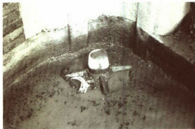
151. Taats op de sluisvloer van de Grote Sluis in het Merwedekanaal te Gorinchem.
