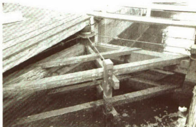
223. Enkele waaierdeur in de Weertsluis te Utrecht.
