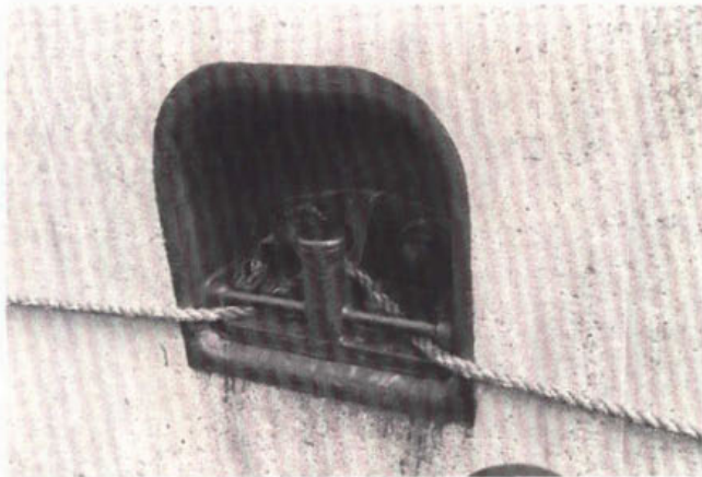
456. Bolder in een stalen haalkom in de Spieringsluis in de Biesbosch.
