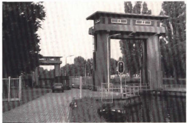
444. Hefstorens in Sluis 16 in de Zuid-Willemsvaart bij Weert.
