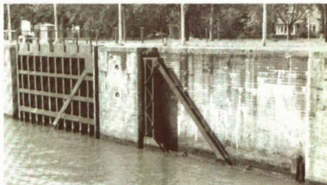
159. Eb- en vloeddeuren in de sluis te Heumen.
