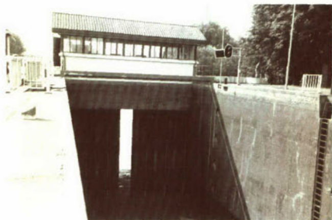
273. Dubbele roldeur in de schutsluis in het Twenthekanaal te Hengelo.
