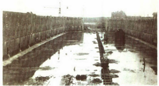
471. Kolkwand met rioolopeningen van de voormalige Oostersluis te Hansweert tijdens de bouw in 1915.
