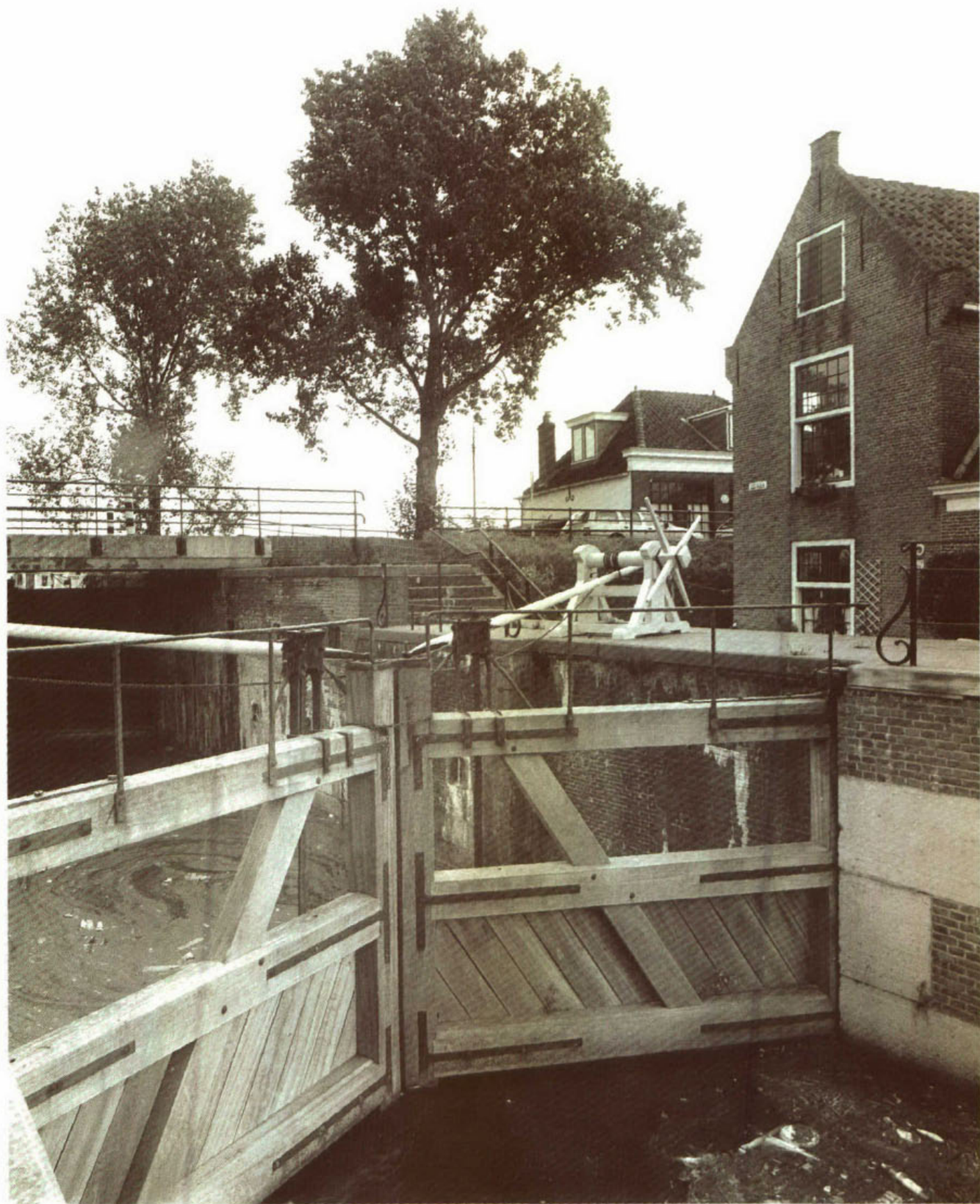
Puntdeuren met kaapstanders in de Kolksluis te Spaarndam, zie pag. 76. (Fotografische Dienst Bouwkunde, TU Delft)
