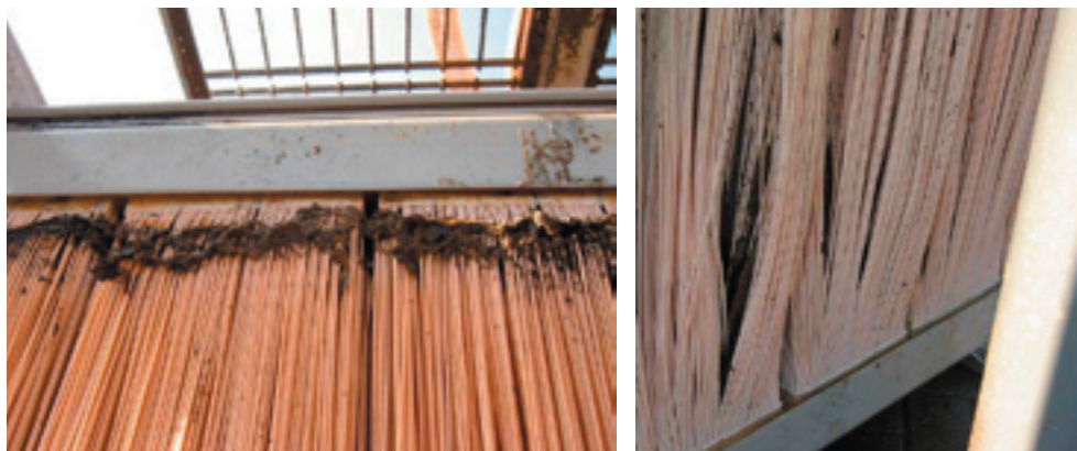
AFBEELDING 34 MACRO-VERVUILING VAN MEMBRANEN (LINKS: VEZELS BOVENIN, RECHTS: SLIBBROKJES ONDERIN)
