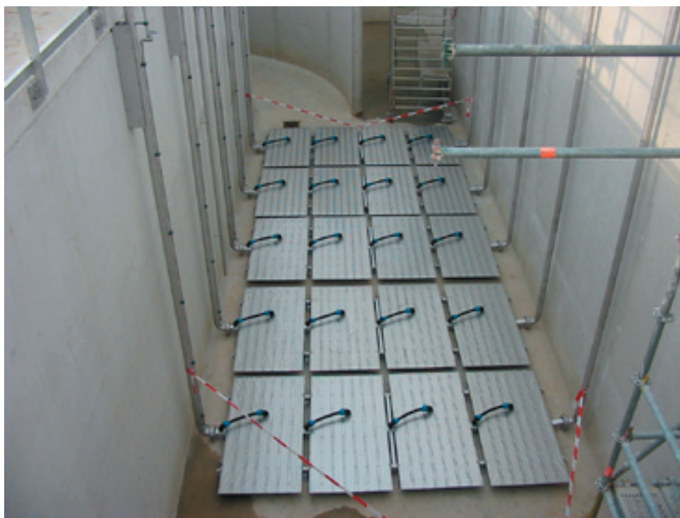
AFBEELDING 4 BELUCHTINGSPLATEN IN RECHTE BEEN BELUCHTINGSTANK
