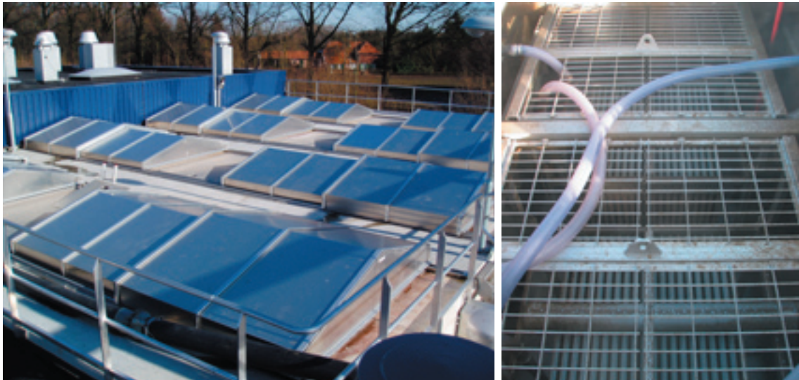
AFBEELDING 2 OVERZICHTSFOTO VAN DE MEMBRAANINSTALLATIE IN VARSSEVELD
