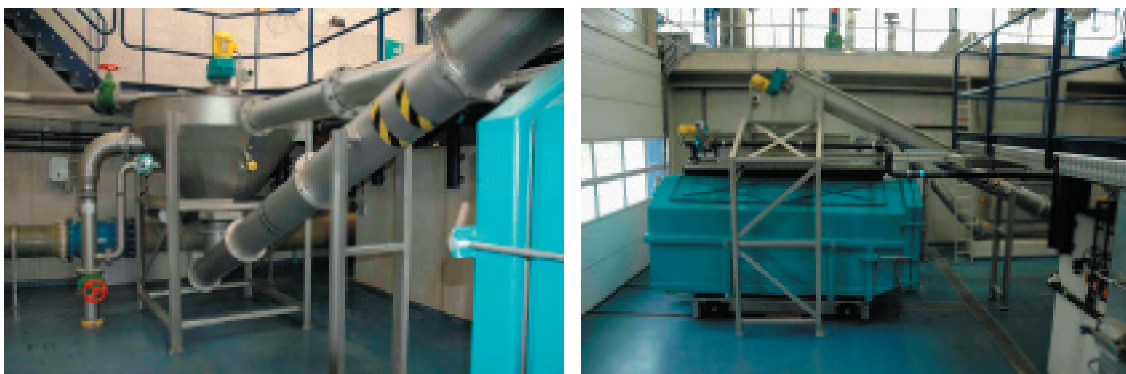
AFBEELDING 7 ZANDWASSER, TRANSPORTSCHROEFFERS EN CONTAINER VOOR OPVANG ZAND
