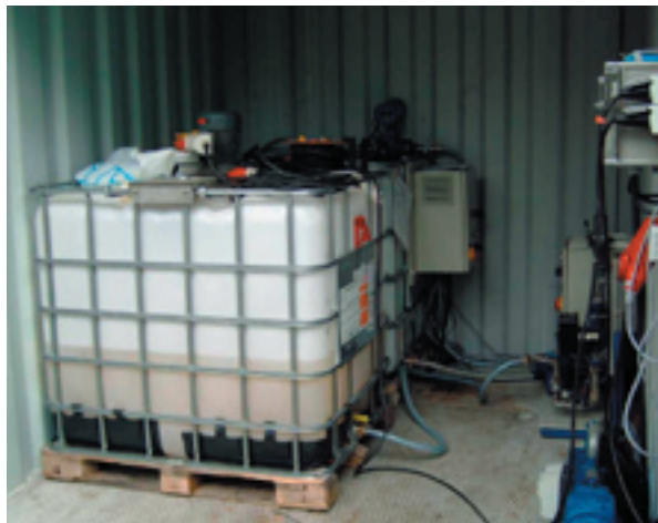
AFBEELDING 4 CONTAINER MET PE-TANK EN DOSEERINSTALLATIE
