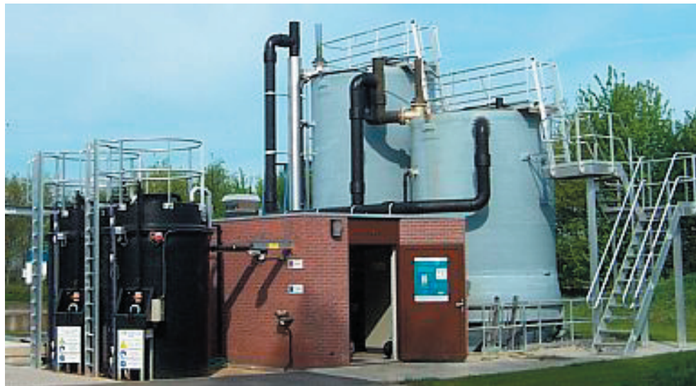
DENITRIFICEREND EN DEFOSFATEREND CONTINUE ZANDFILTERS, RWZI MAASBOMMEL
