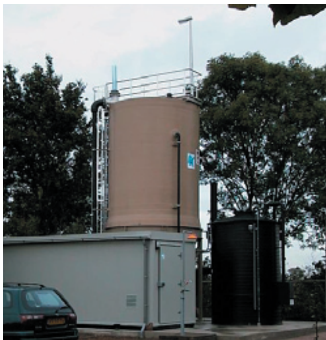
CONTINU ZANDFILTER VOOR FOSFAATVERWIJDERING, RWZI KAATSHEUVEL
