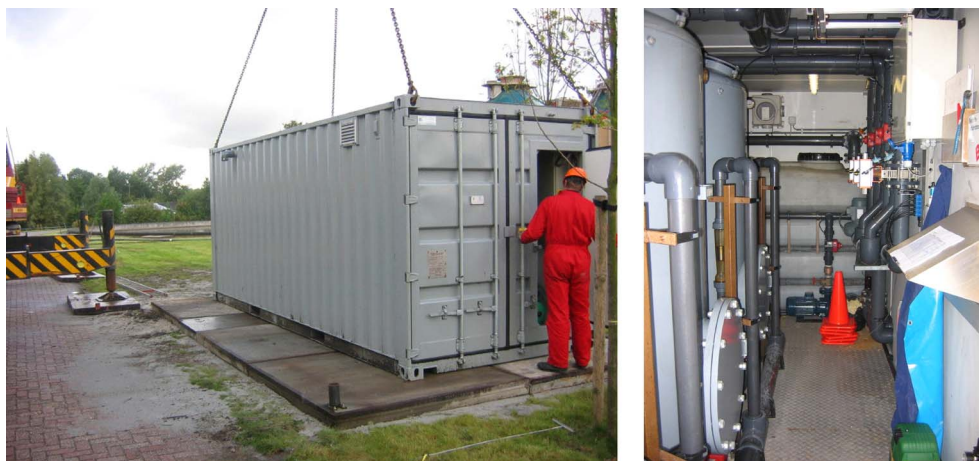
FIGUUR 6: DISCONTINU ZANDFILTER RWZI LEEUWARDEN
