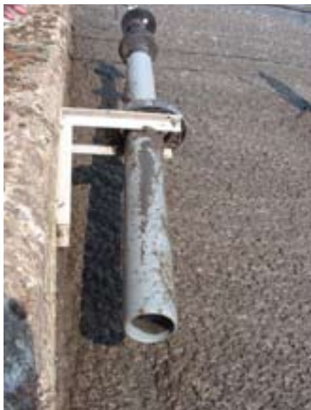
a. bescherming redoxmeting (onder waterniveau)
