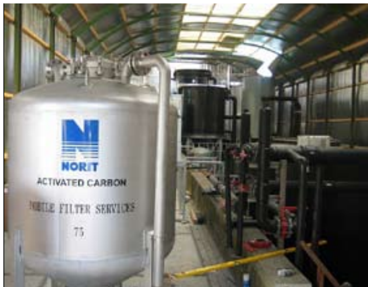
AFBEELDING 14 DEMONSTRATIE-INSTALLATIES RWZI LEIDEN ZUID-WEST MET OP VOORGROND ACTIEFKOOLFILTERS
