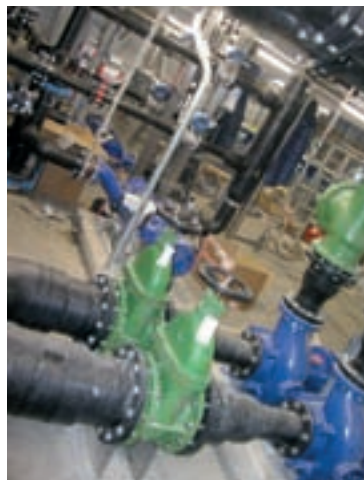
TECHNISCHE RUIMTE MET SLIBCIRCULATIEPOMPEN
