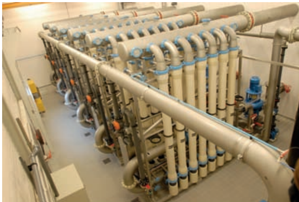
OPSTELLING MEMBRAAN UNITS
