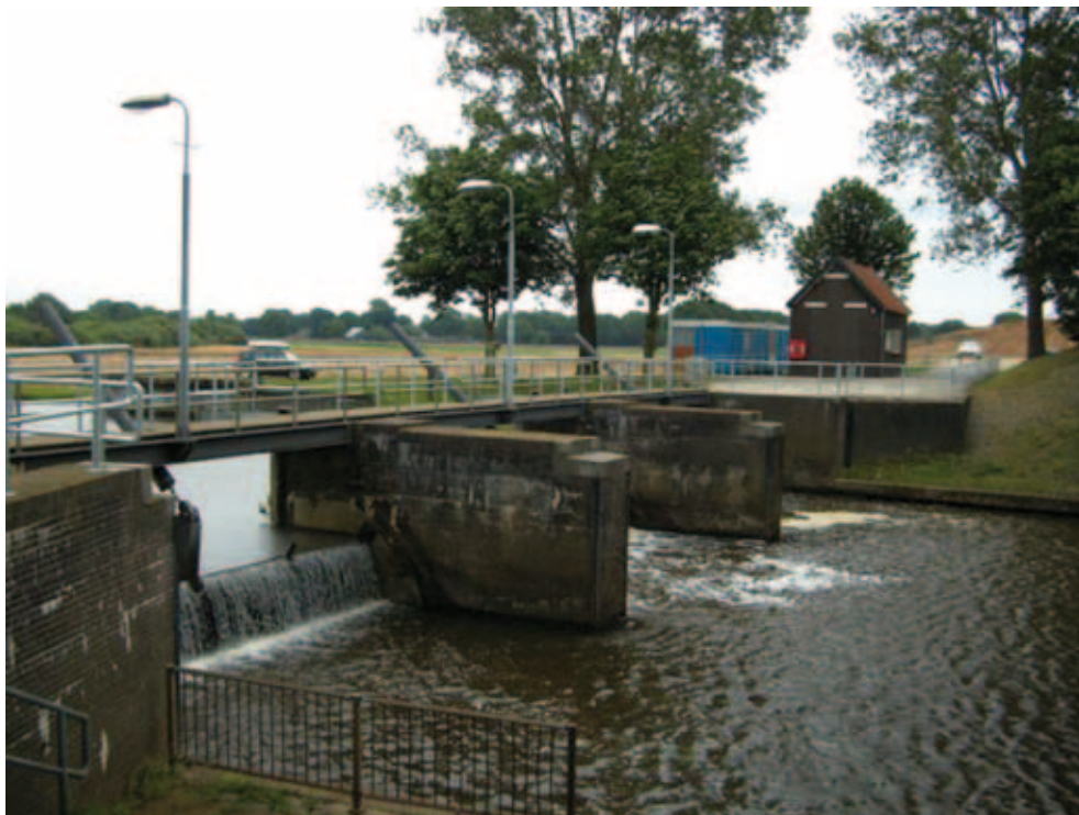
HYDRAULISCHE KLEPSTUW BIJ MARIËNBERG IN DE OVERIJSSSELSCH VECHT (FOTO: HKV LIJN IN WATER)
