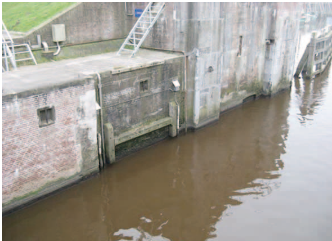
FOTO 6-20 ADM PROVINCIALE SLUIS ZOUTKAMP (FOTO: WS NOORDERZIJLVEST)
