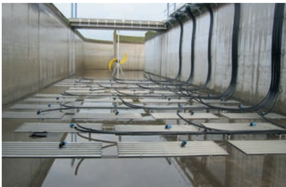
AFBEELDING 3.6 BELUCHTINGELEMENTEN (PLATEN) IN DE RWZI ZWIJNDRECHT
