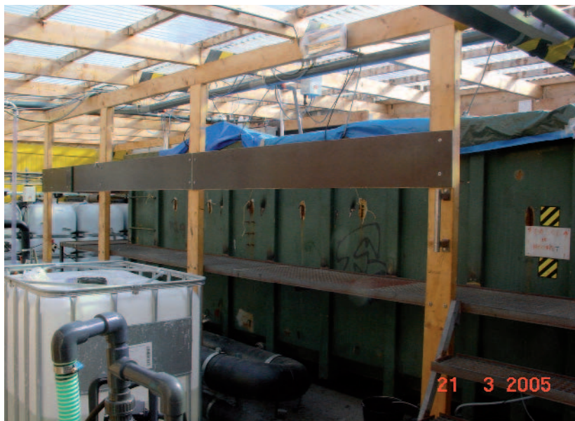
AFBEELDING 4 PROEFINSTALLATIE NA OMBOUW
