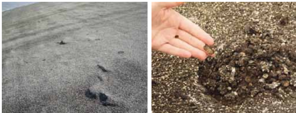
LINKS, ENKELE ZEER PROMINENTE OPBOLLINGEN; RECHTS, OPEN GEBROKEN OPBOLLING TOONT LOKAAL VOLLEDIG UITEENGEVALLEN GRINDASFALT
