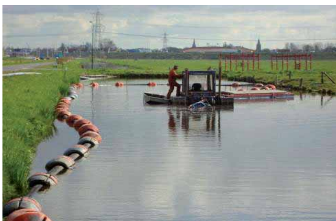
FIGUUR 6 BAGGEREN VAN EEN WATERGANG MET EEN ZUIGERBOOT EN TRANSPORT VAN DE BAGGER VIA EEN PIJPLIJK.
