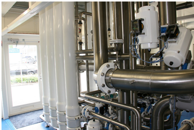
FIGUUR 2.5 MBR-SKID MET BUITEN DE BIOLOGISCHE TANK OPGESTELDE MEMBRANEN
