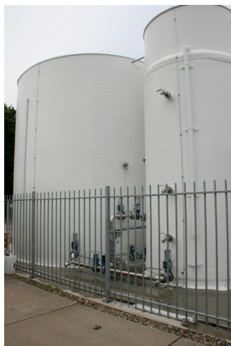
HYDROLYSE EN VERGISTER
