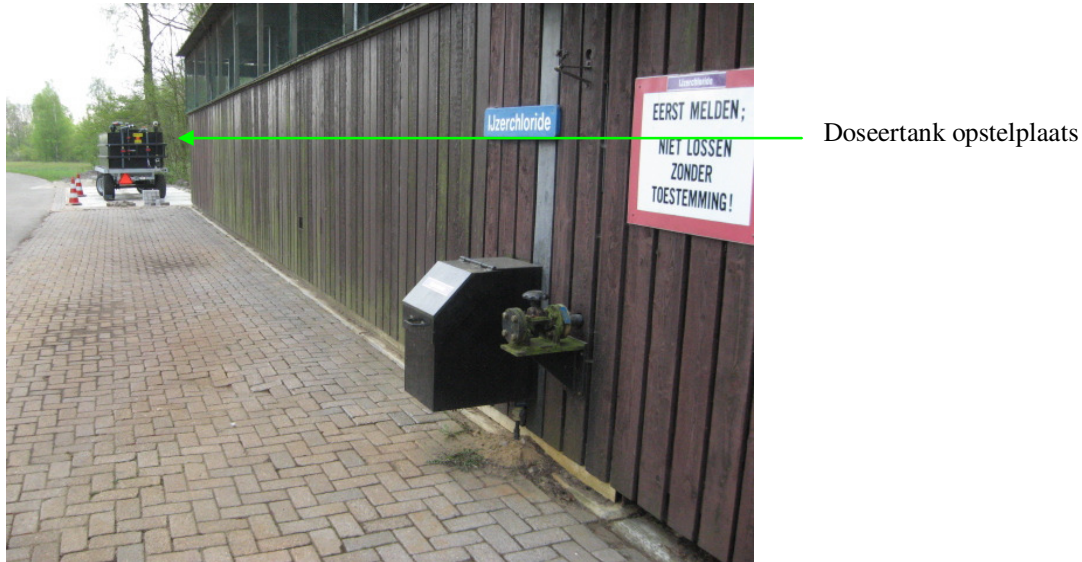
Afbeelding 3-21: Opstelplaats voor doseertank
