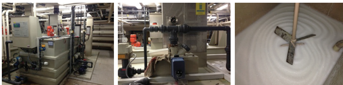
AFBEELDING 12 SLIBONTWATERING KRALINGSVEER. LINKS: POLYMEERAAANMAAKTANK VOOR CENTRIFUGE 2, MIDDEN: MENGPIJP VOOR POLYMEER EN WATER, RECHTS: ROERDER IN VOORRAAD TANK
