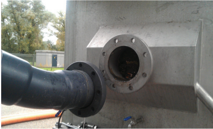
AFBEELDING 4.1 TOEVOER DAF-INSTALLATIE MET VERSTOPPING
