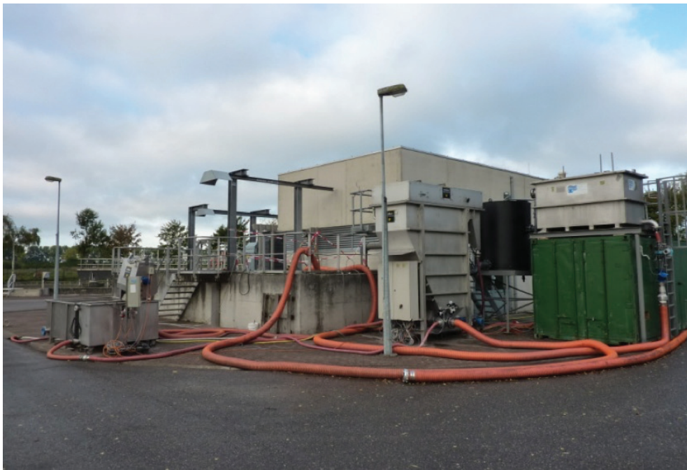
AFBEELDING 3.1 DAF-INSTALLATIE OP RWZI LIENDEN
