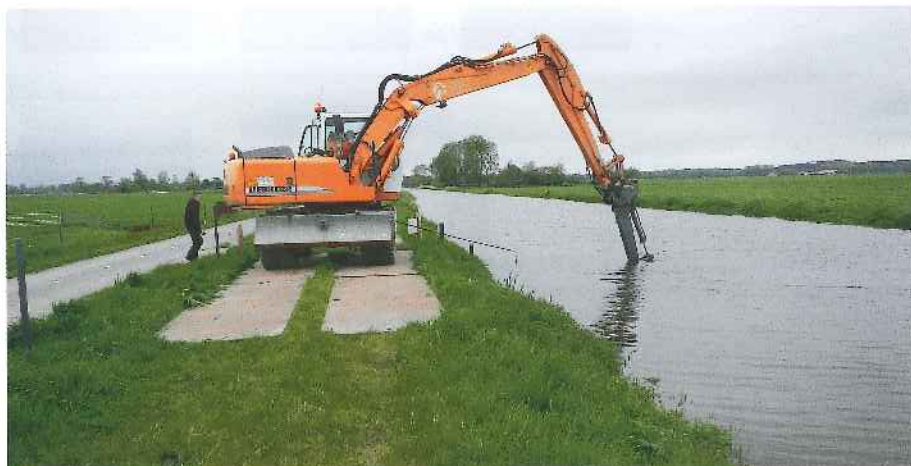
Weggraven van de boezembodem in de Rekerpolder om hydraulische kortsluiting te creëren voor het onderzoek.
