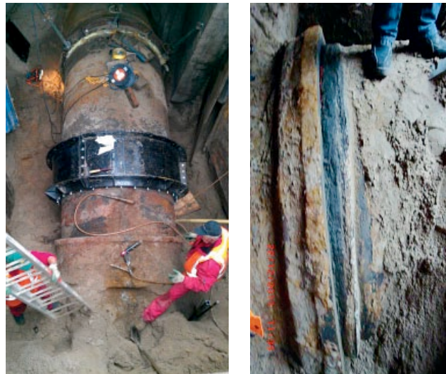
Figuur 3.15 Foto's lekkage leiding door zetting
