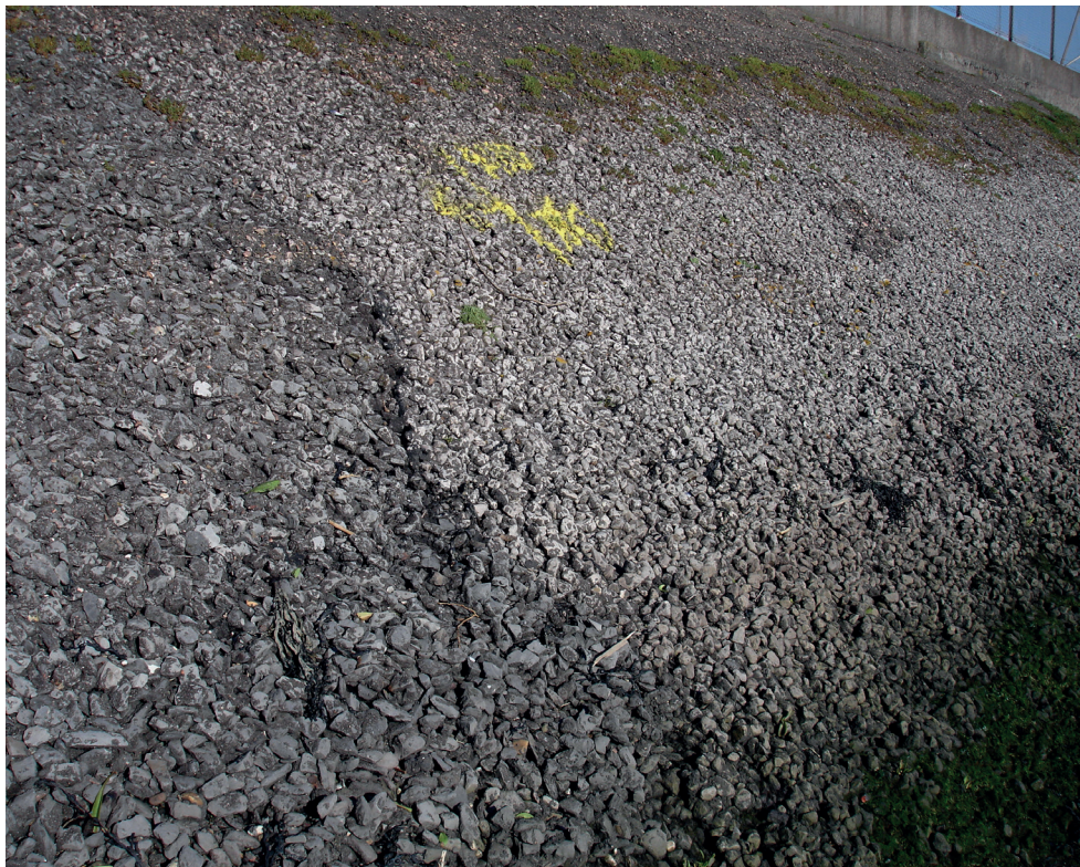
VOORBEELD VAN EEN SCHEUR IN OPEN STEENASFALT
