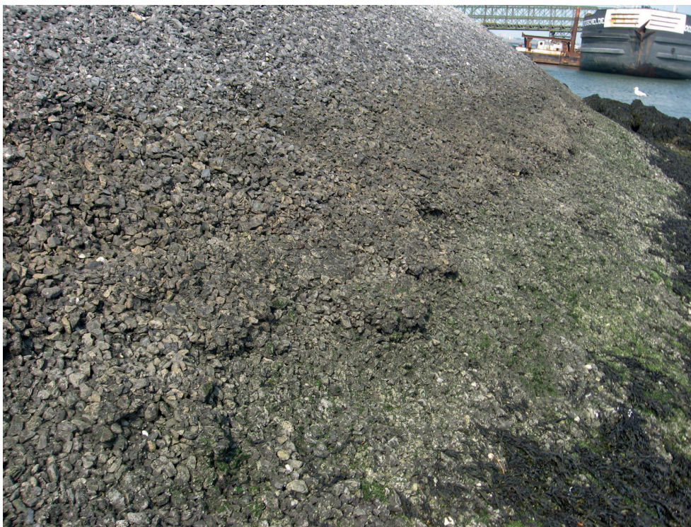
VOORBEELD VAN EROSIE ONDER DE HOOGWATERLIJN
