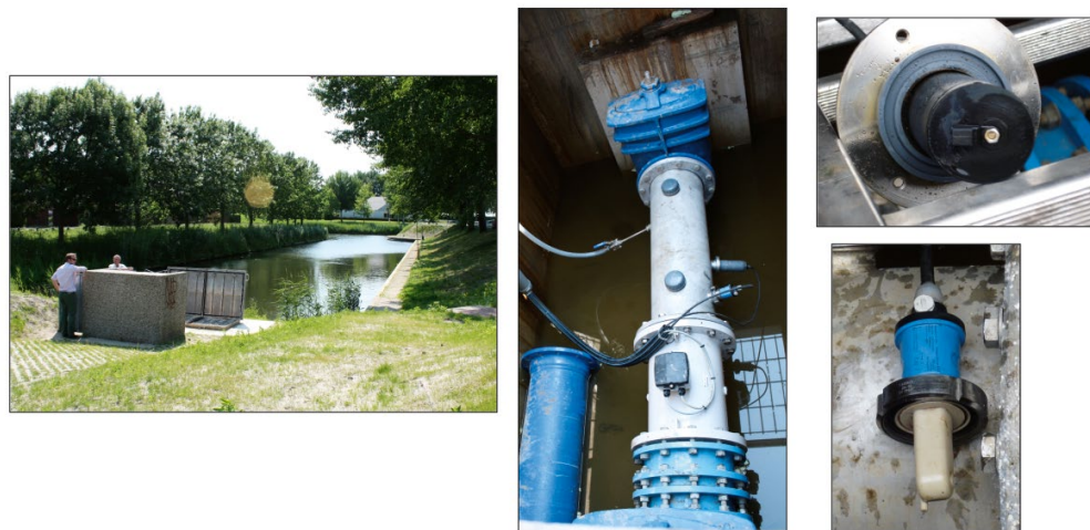
Figuur 3.21 Overzicht meetlocatie Sluis (links), nieuwe buis met aanzuigslang en sensoren (midden) en gedemonteerde troebelheids- en geleidbaarheidssensoren (rechts)
