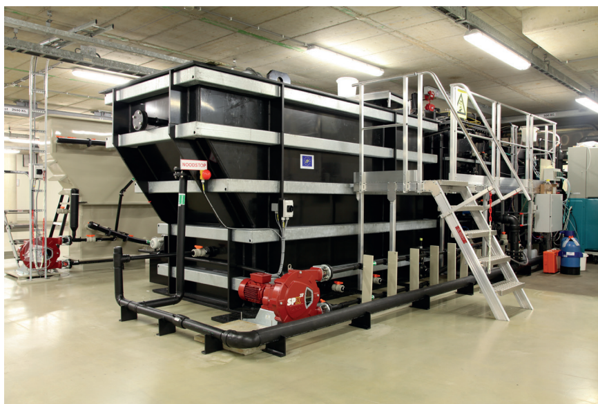
DEMONSTRATIE INSTALLATIE OP RWZI DOKHAVEN
