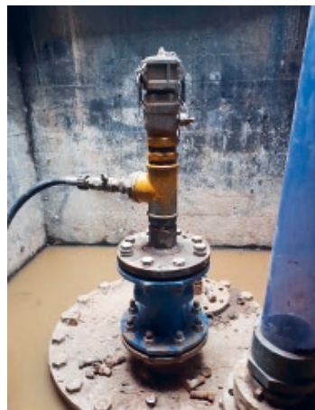
Figuur 4.22 Drukmeting op afsluiter (links) en schrijvende meter (rechts)
