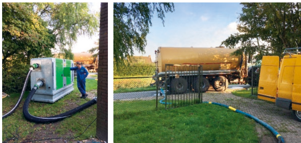
Figuur 4.5 Pompunit en watervoorraad beproeving 20 september
