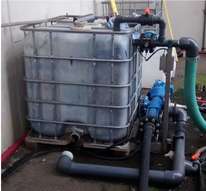
VLOTTERTANK EN TOEVOERPOMP BORSTELCENTRIFUGE
