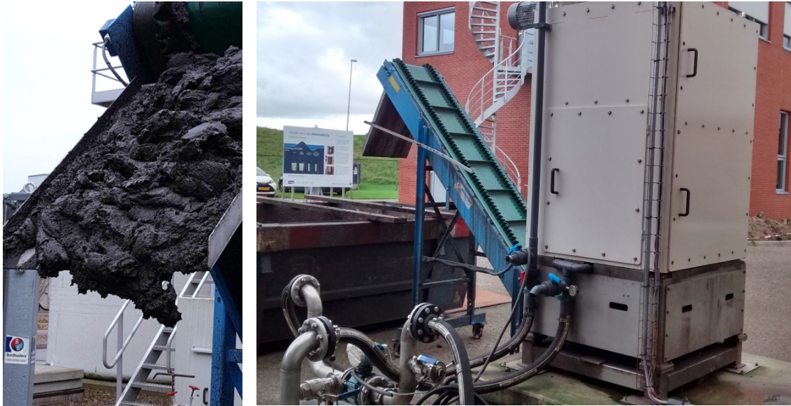
FIGUUR 4.1 AFVOER VAN DOOR BORSTELCENTRIFUGE ONTWATERD SLIB (LINKS) BORSTELCENTRIFUGE IN OMKASTING (RECHTS)
