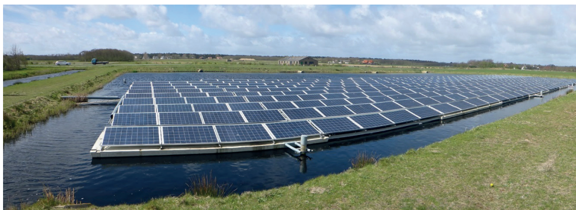
FOTO 4.2 OVERZICHT VAN HET PV-SYSTEEM IN HET NA-BEZINKBASSIN RWZI EVERSTEKOOG, DE KOOG, TEXEL. DE PANELEN LIGGEN OP DRIJVENDE PONTONS. VOORAAN MIDDEN EEN VAN DE PALEN WAAR HET SYSTEEM AAN VASTGEMAAKT IS. LINKS DE AANLANDING VAN DE KABELS EN DE LOOPBRUG VOOR TOEGANG TOT HET PV-SYSTEEM VANAF DE KANT. AAN DE ACHTERZIJDE ZIJN DE BUIZEN VOOR AFVOER VAN HET WATER NAAR HET OPPERVLAKEWATER ZICHTBAAR
