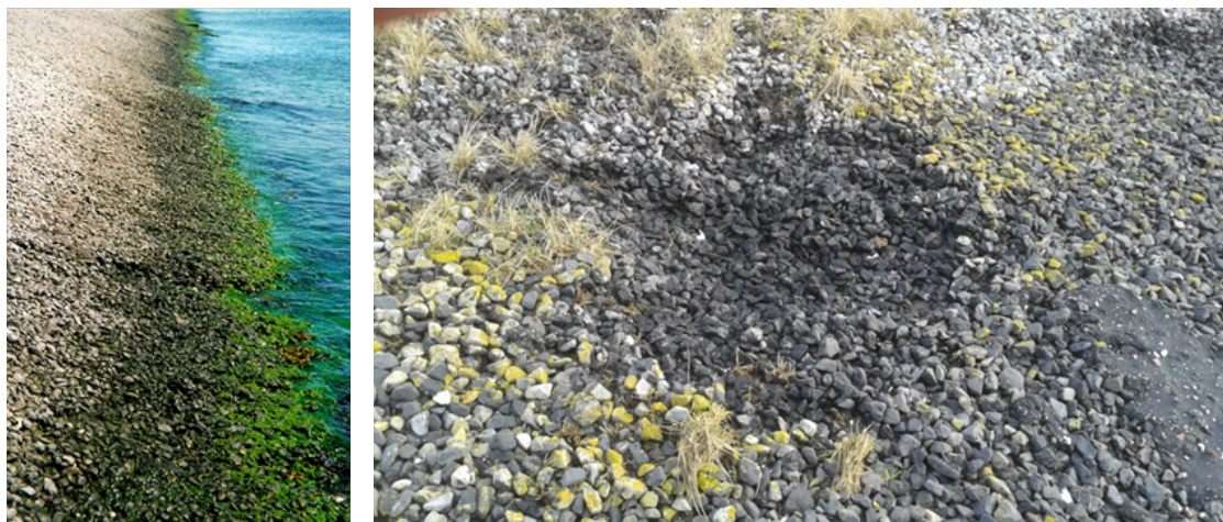
FIGUUR 8 AANGETAST OPPERVLAK OPEN STEENASFALT IN DE TIJZONE (LINKS) EN LOKAAL AANGETAST OPPERVLAK WAARVAN RECENT STENEN UIT DE BEKLEDING ZIJN VERDWENEN (RECHTS)
