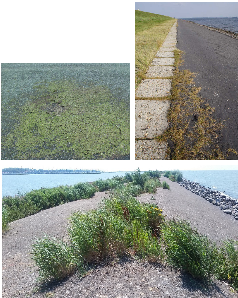
FIGUUR 13 VEGETATIE OP (ALGEN, LINKSBOVEN), IN (GRAS, RECHTSBOVEN) EN DOOR (RIET, ONDER) DE BEKLEDING
