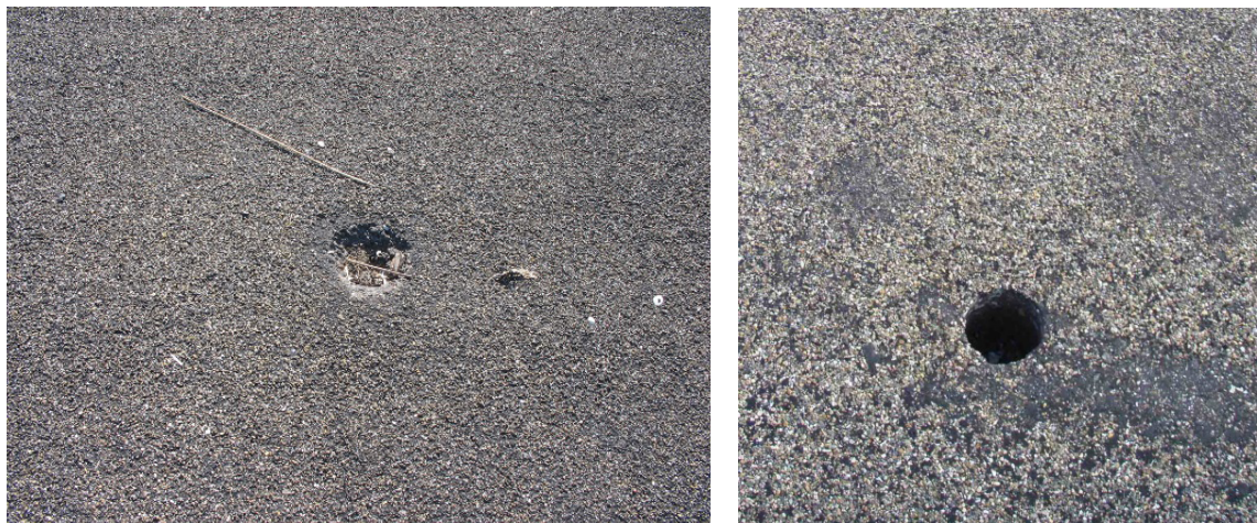
FIGUUR 11 GATTEN GEVOLGE VAN EEN STEMPEL (LINKS) EN EEN BOORGAT DAT NIET VOLLEDIG IS GEVULD (RECHTS)
