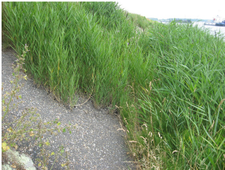
FIGUUR 24 AANTASTING WATERBOUWASFALTBETON DOOR RIET
