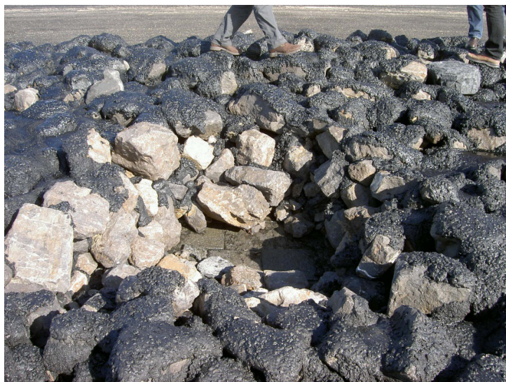
FIGUUR 12 GAT IN VOL EN ZAT GEOPENETREERDE BREUKSTEEN, ONTSTAAN KORT NA AANLEG DOOR HET TOEPASSEN VAN ONVOLDOENDE GIETASFALT
