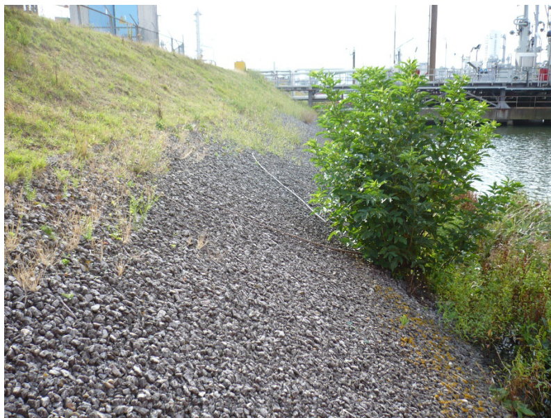
HOUTVORMENDE VEGETATIE (VLIERBES) IN OPEN STEENASFALT
