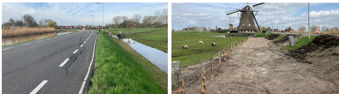
Figuur 7 Verzakkingen langs de regionale keringen bij de N468 tussen Schipluiden en Maasland (links). De sloot naast de dijk is gedempt en volgestort met zand om de dijk te verstevigen (rechts)
