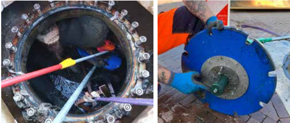
Figuur 3.9 Reinigingspig komt aan bij de ontvangstput met daarvoor de vervormde reinigingspig en afgebroken centreerschijf (U). Rechts de centreerschijf
