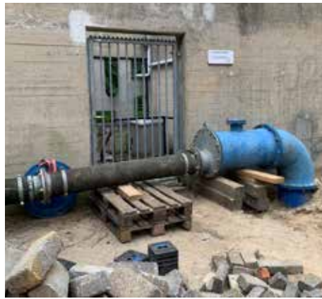
Figuur 2.5 Tijdelijke pompinstallatie (l) met aansluiting op de lanceer-inrichting (r).
