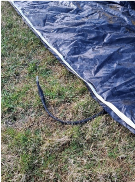
Figuur 2.38 Bij het verplaatsen van de TubeBarrier werd een drainagebuis aan de onderzijde van de TubeBarrier er uitgetrokken.
