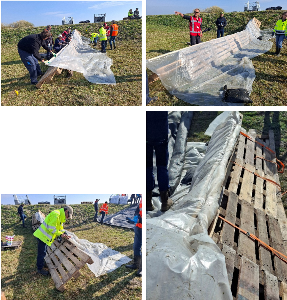
Figuur 2.26 Inrollen van panlatten in de folie in verkeerde richting aan de bovenkant van de Europallet constructie. Hierdoor ontstaat een kuil.
