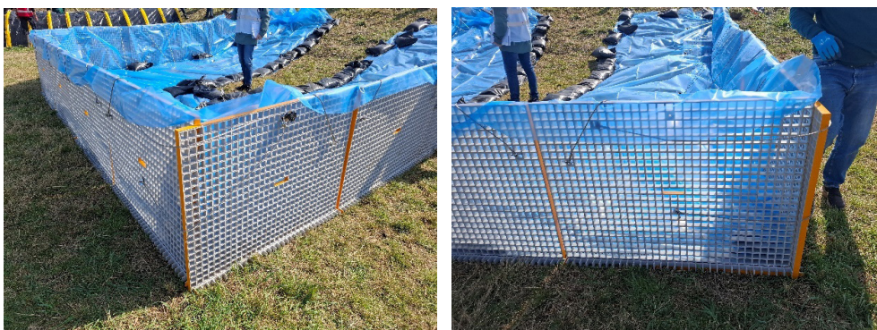
Figuur 2.65 Ook hier is de verankering van de spandraden aan de achterkant van de panelen niet volgens de instructie van de leverancier uitgevoerd. Sommige draden verlopen horizontaal om de hoek naar het volgende paneel. Er zit geen spanning op de draad. Deze schuift makkelijk op een neer.
