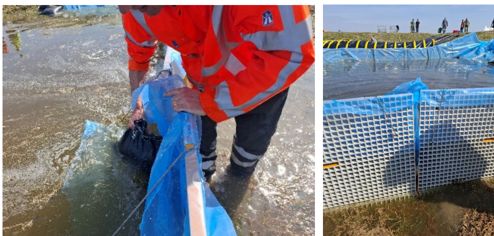
Figuur 2.73 De folie wordt met een zandzak tegen de binnenkant van de L-vormige module aan gefixeerd. De lekkage komt bijna volledig tot stilstand.
