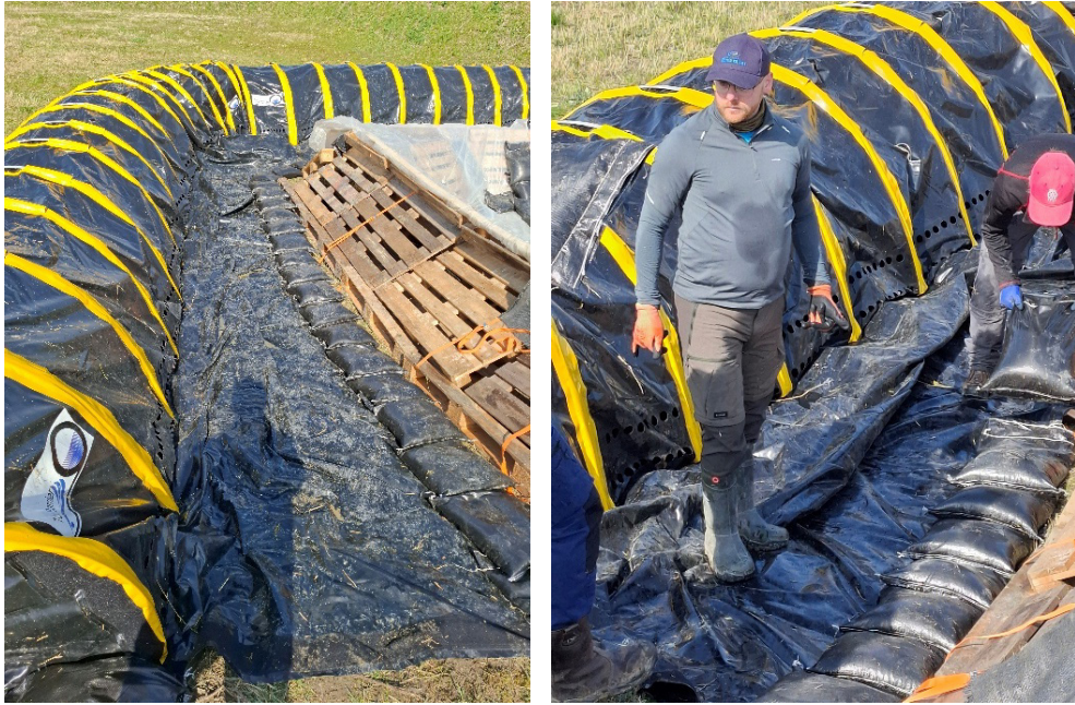
Figuur 2.43 Duidelijk zichtbaar is de heel onregelmatige aansluiting van de folie op de grasondergrond.
