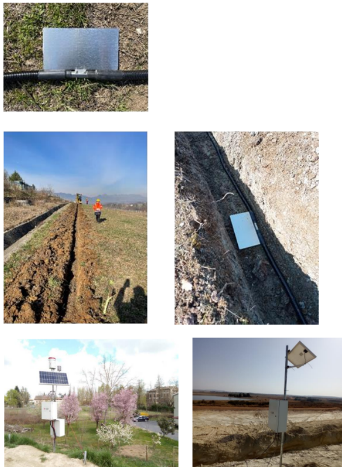
Figuur 11 In-situ monitoringsopstelling ERT
