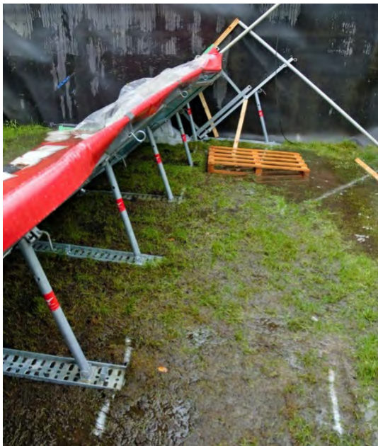
Figuur 3.4 Steunpilaren die na het opstuwen in de verzadigde grond zijn gezakt (Aqua Defence) (Lankenau e.a. 2020).
