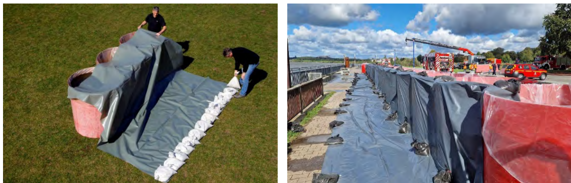
Figuur C 6 De afdichting aan de kant van het hoogwater gebeurt met een afdichtingszeil. Dit wordt 2 meter voor de cilinder op de grond met zandzakken vastgezet om de afdichting te optimaliseren.
