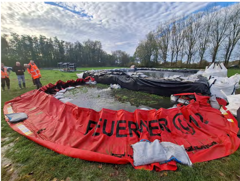
Figuur D.17 Het water stroomt via een buis vanuit het bassin de halfronde nooddam in. De Waterdam is hier met behulp van steunen helemaal omhoog geklapt.
