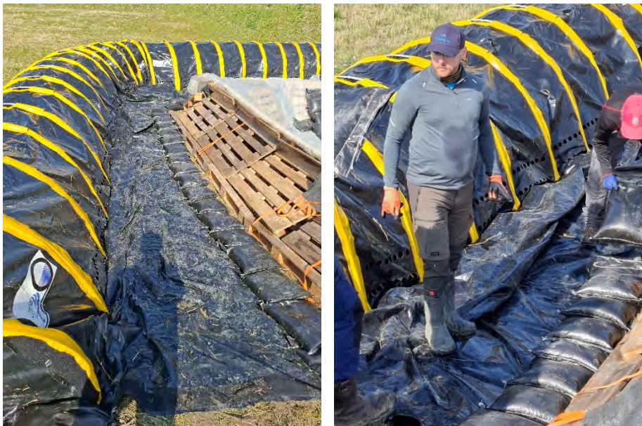
Figuur C 87 Duidelijk zichtbaar is de heel onregelmatige aansluiting van de folie op de grasondergrond.
