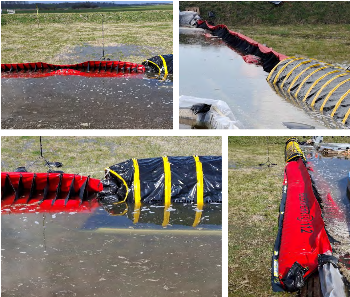
Figuur C 33 De overgang tussen BFW en TubeBarrier lijkt hier het zwakke schakel qua hoogte te vormen. Maar ook het feit dat in voorliggende situatie het op de grond liggende gedeelte van de BFW niet met zandzakken werd verzaamd. Hierdoor gaat het zeil gedeeltelijk opdrijven en de BFT verschuiven.
