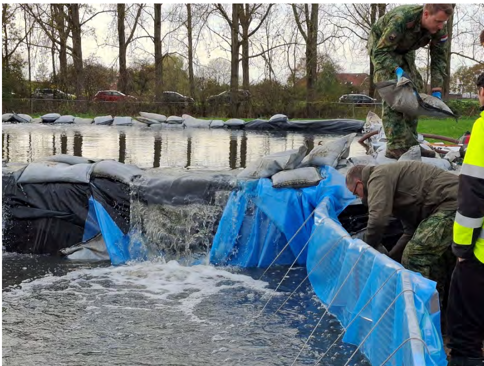
Figuur D.104 De oorzaak voor het lekwater is hier echter dat het membraan te ver langs het bassin is geleid, waardoor het uit het bassin stromende water tussen bassin en membraan terecht komt.
