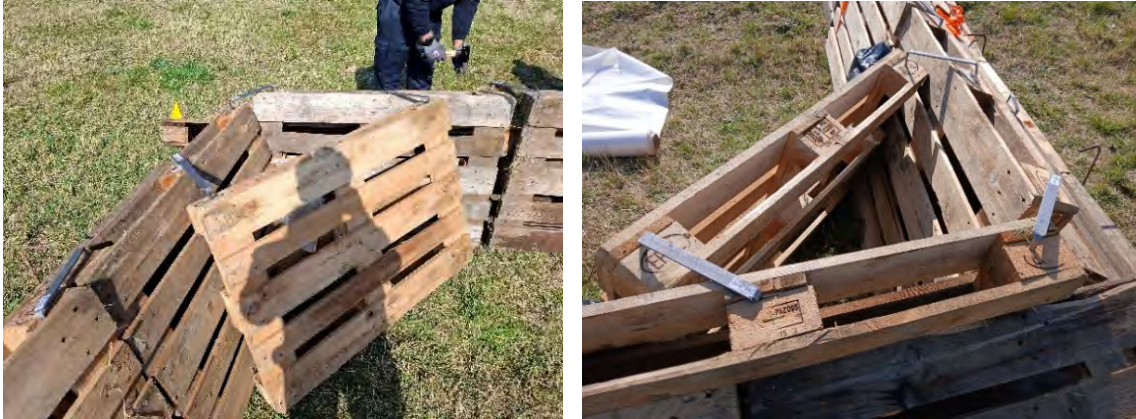
Figuur C 97 Om bochten of rechthoekige richtingswisselingen te kunnen realiseren wordt een extra pallet op de tegen de hoek aan geplaatst. Een 3-pallet systeem in L-vorm. De hoek is versterkt d.m.v. een extra pallet die met brede korte krammen is gefixeerd.
