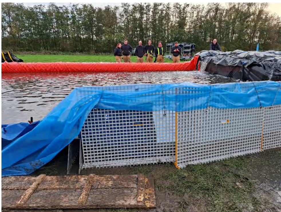
Figuur D.102 De verbinding tussen de twee systemen werkt goed en blijft waterdicht.
