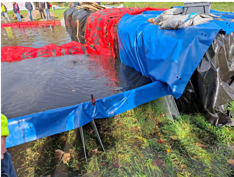
Figuur D.44 Ook bij het Geodesign Barrier systeem treedt ondanks het schort onderloopsheid op. De voetsteunen drukken op de verzadigde grond.
