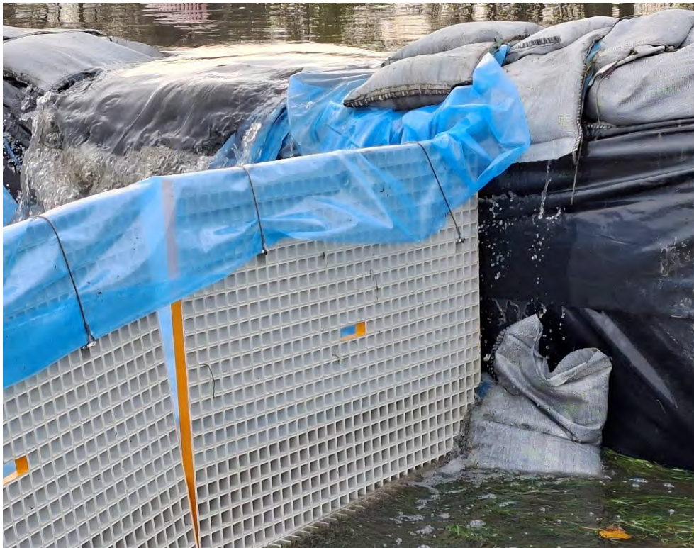
Figuur D.103 Water lekt langs de aansluiting van het Haawal-systeem met het waterbassin.
