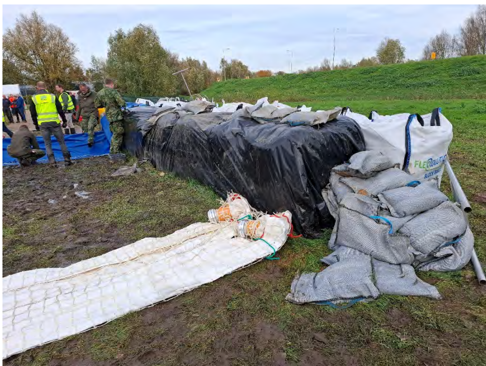
Figuur D.54 Nog niet gevulde Mobildeich ligt tegen de wandconstructie aan.
