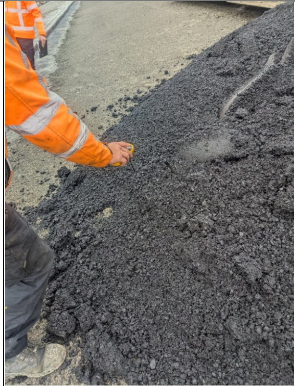
Figuur 2 Detail temperatuurmetering. Dit wordt steeds 5x gedaan direct na het lossen
